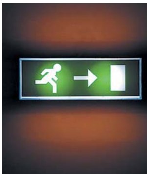
emergency exit [ɪˌmɜːdʒənsɪ'egzɪt] имé:джэнси эгзит пожарный выход
